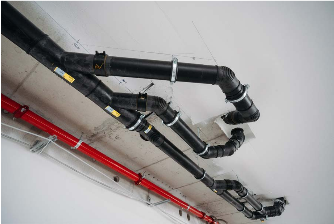
↑ Die hochschallgedämmten Geberit Silent-db20 kamen sowohl bei der Dach- als auch bei der Hausentwässerung zum Einsatz.
